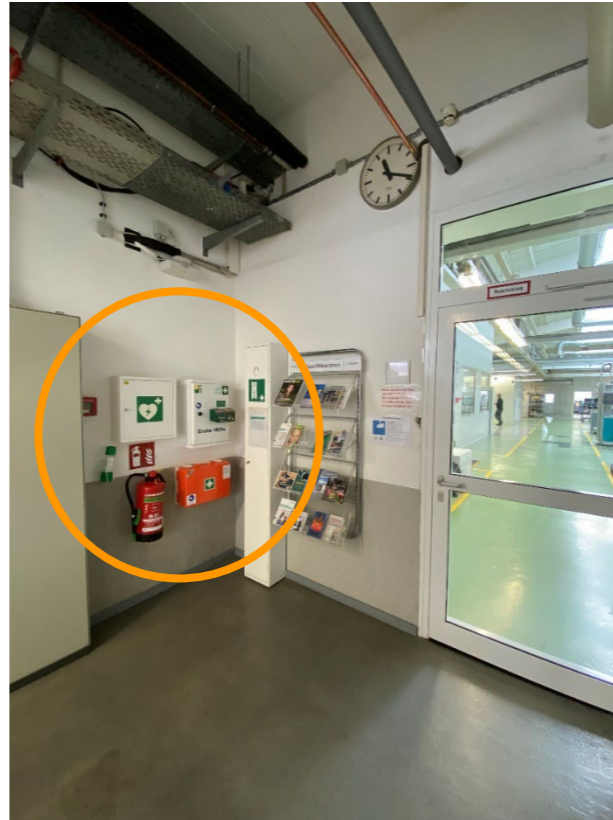
Gebäude 1: im Innenflur (Eingang Produktion / Nähe Automaten)
