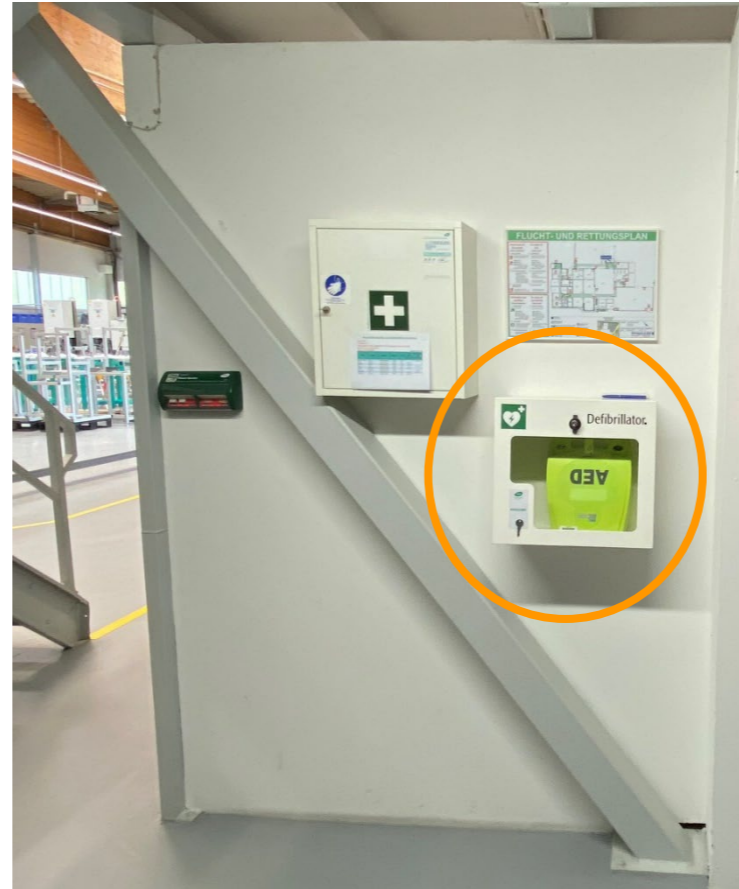
Gebäude 7: bei Nebeneingang Produktion (bei Brandmeldeanlage)
