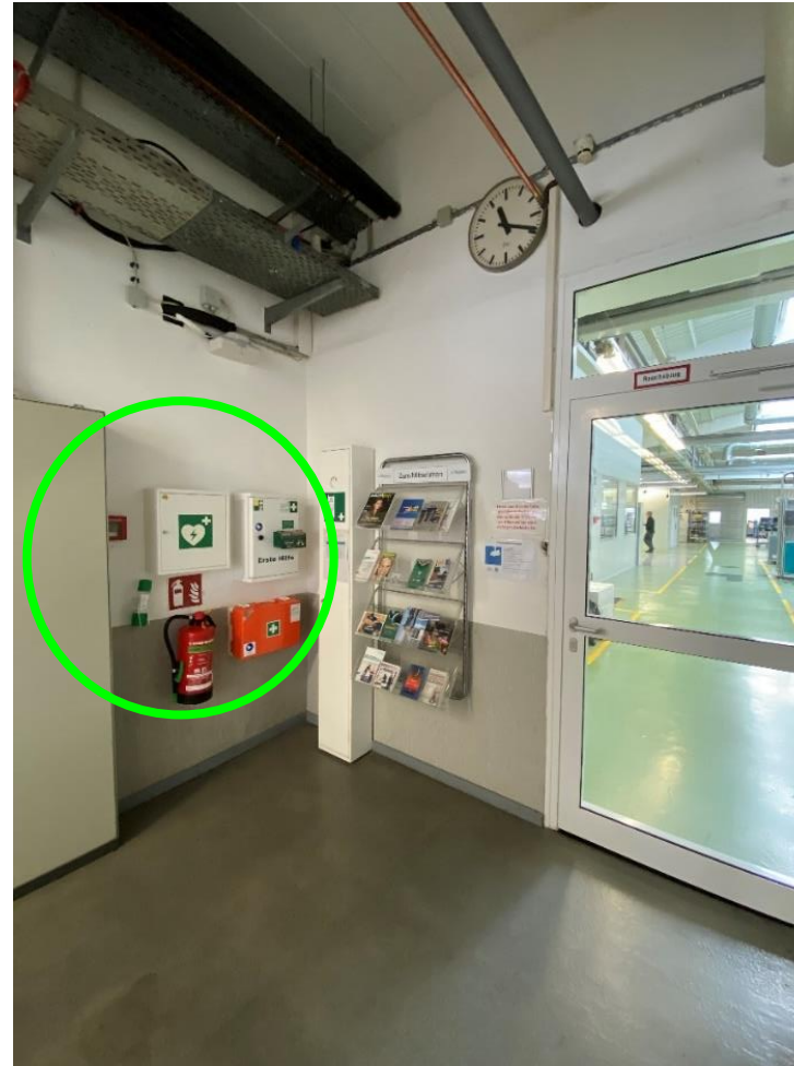
Gebäude 1: im Innenflur (Eingang Produktion / Nähe Automaten)
