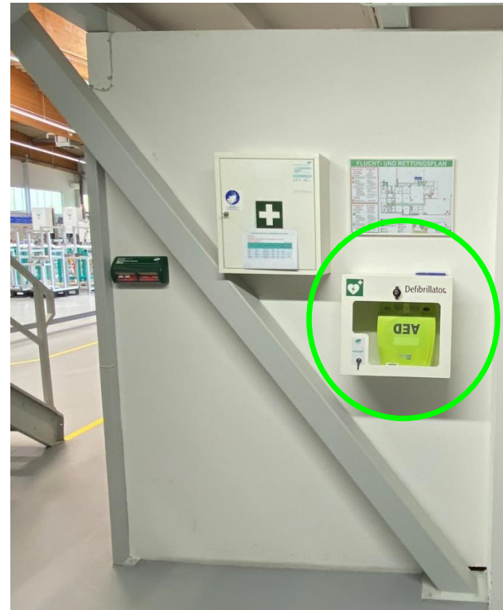
Gebäude 7: bei Nebeneingang Produktion (bei Brandmeldeanlage)
